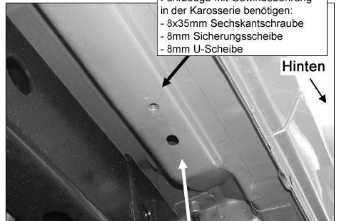
(Bild 2) Beispiel der Baujahre von 2010-2015 mit geschlossenem Unterboden und 8mm Gewindebohrungen. Hier wird die 10mm Mutter Platte nicht benötigt.
